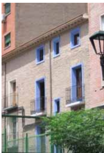
Figura 18: Fachada desollada de ladrillo en Zaragoza Foto M. de Luxán
