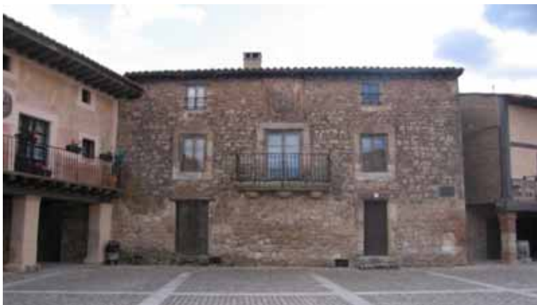
Figura 11: Fachada desollada en la Plaza de Medinaceli (Soria) Foto M. de Luxán
