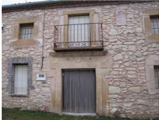
Figura 14: Fachada desollada en Torre Val de San Pedro (Segovia) Foto G. Gómez
