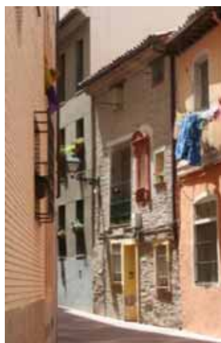
Figura 19: Fachada desollada de ladrillo en Zaragoza Foto G. Gómez
