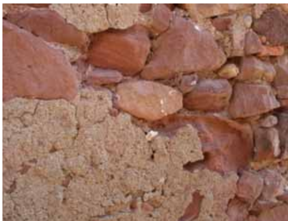
Figura 8: Detalle de fachada deteriorada de piedra con mortero tradicional en Villafamés (Castellón) Foto G. Gómez
